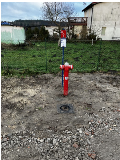
Fotografia 36: Elementy sieci wodociągowej w Nowym Dworze
