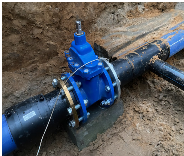
Fotografia 37: Elementy sieci wodociągowej w Nowym Dworze
