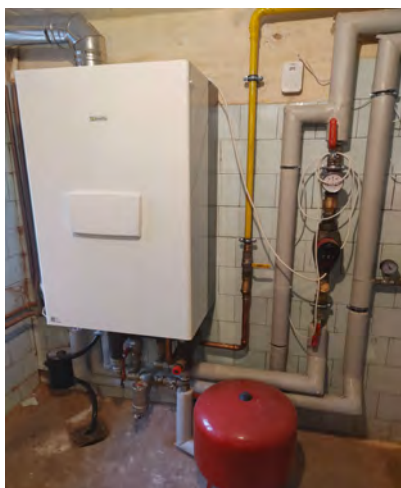
Fot. 23: Wewnętrzna instalacja gazowa w budynku przy Placu Wolności 3
